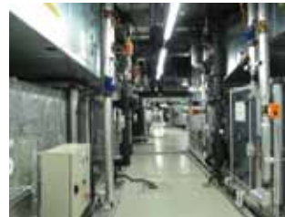
Die Lüftungszentrale der Philharmonie
