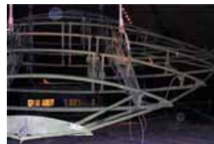
Le chantier de la Salle de Musique de Chambre (photo: Jean-Paul Croatti)
